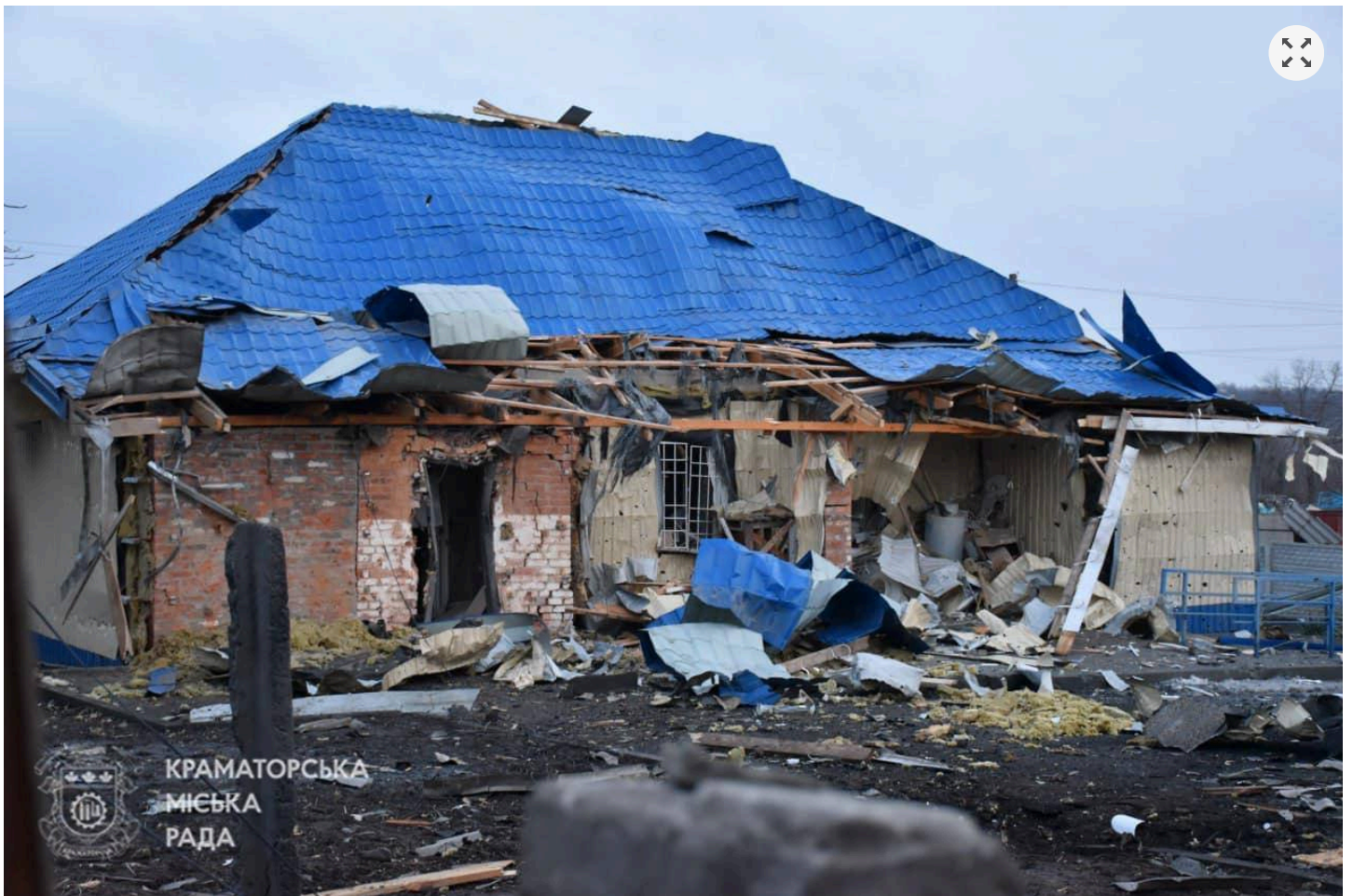
Зруйнована росіянами амбулаторія
