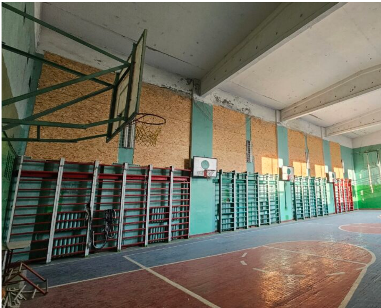
Спортивна зала зазнала сильних пошкоджень через те, що вибух стався з цього боку будівлі. © Фото від співробітників ЮНОПС
