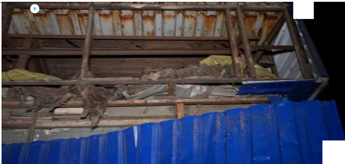
Наслідки обстрілу, Запоріжжя, 19 жовтня 2024 року. Суспільне Запоріжжя
