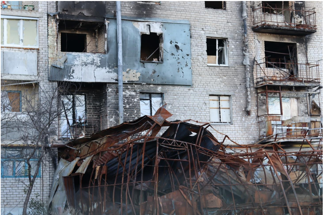
Зруйнований будинок у Старому Салтові, жовтень 2022 рік / Gwara Media
