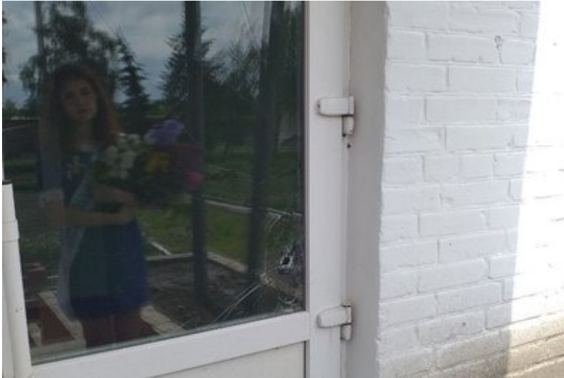
Одинадцятикласниця не може відчинити двері ліцею, бо заклад освіти пошкоджено через російські обстріли. Фото: Аліна Крупеня
