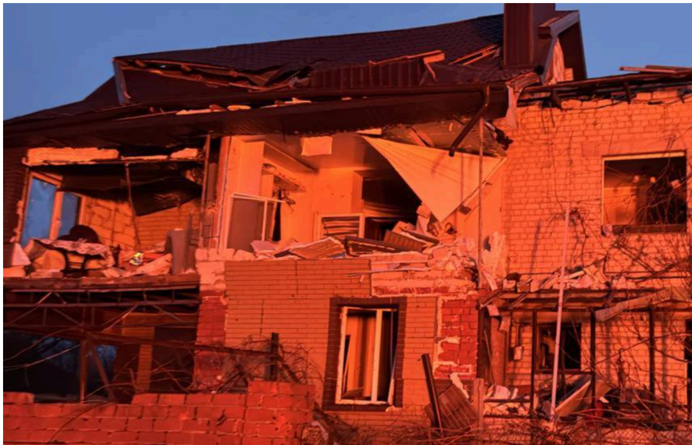
Наслідки обстрілу Слатине 6 березня / Фото: Харківська обласна прокуратура
