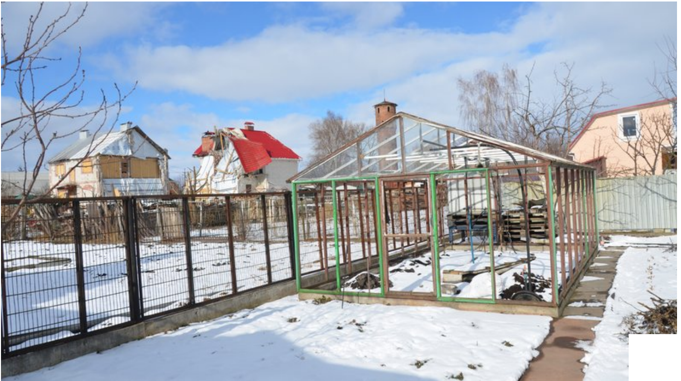
Пошкоджена теплиця та частково зруйновані будинки. Суспільне Чернігів
