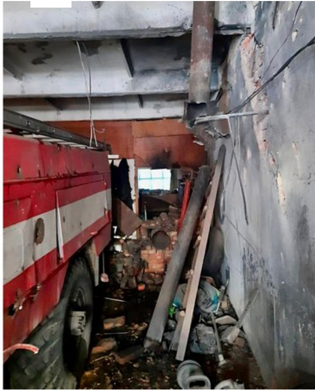
Пошкоджене приміщення та автомобіль підрозділу пожежної команди. В'ячеслав Чаус
