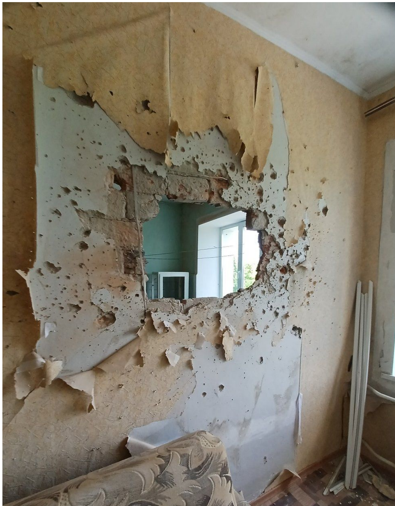
Військові пошкодження всередині будівлі в Україні
