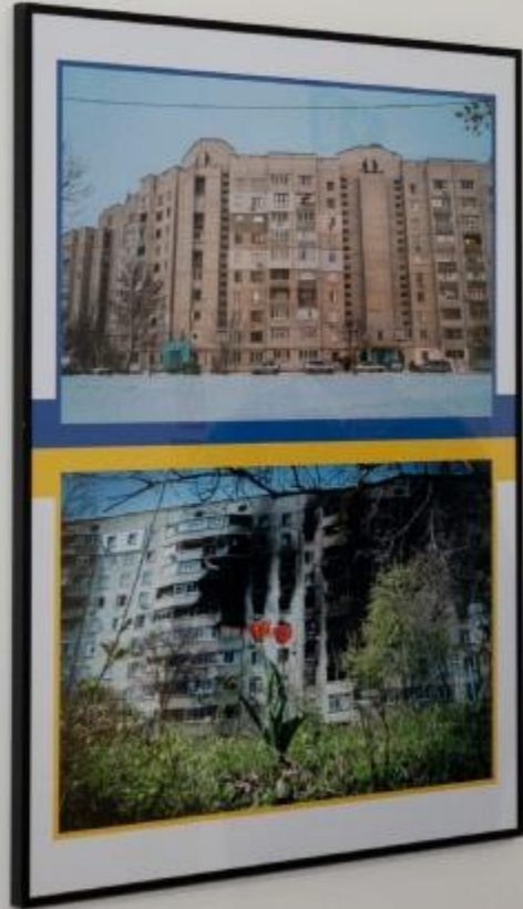
Слика зображує будинок, який був пошкоджений під час війни. Зверху зображено будинок до війни, знизу - після війни.
