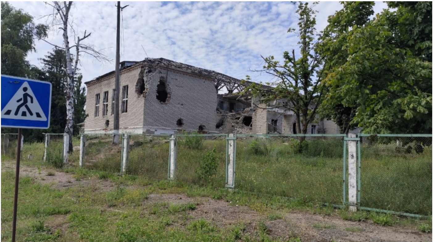
Залиманський ліцей, зруйнований обстрілами
