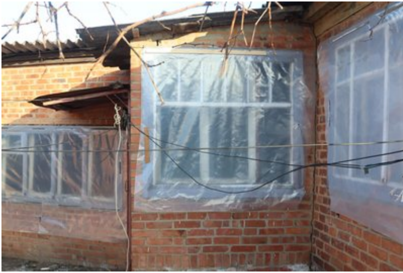
Пошкоджений будинок в Охтирці. Суспільне Суми
