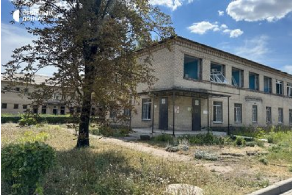
Пошкоджена російськими обстрілами будівля інфекційної лікарні, Мирноград, Донецька область, 1 серпня 2024 рік. Суспільне Донбас
