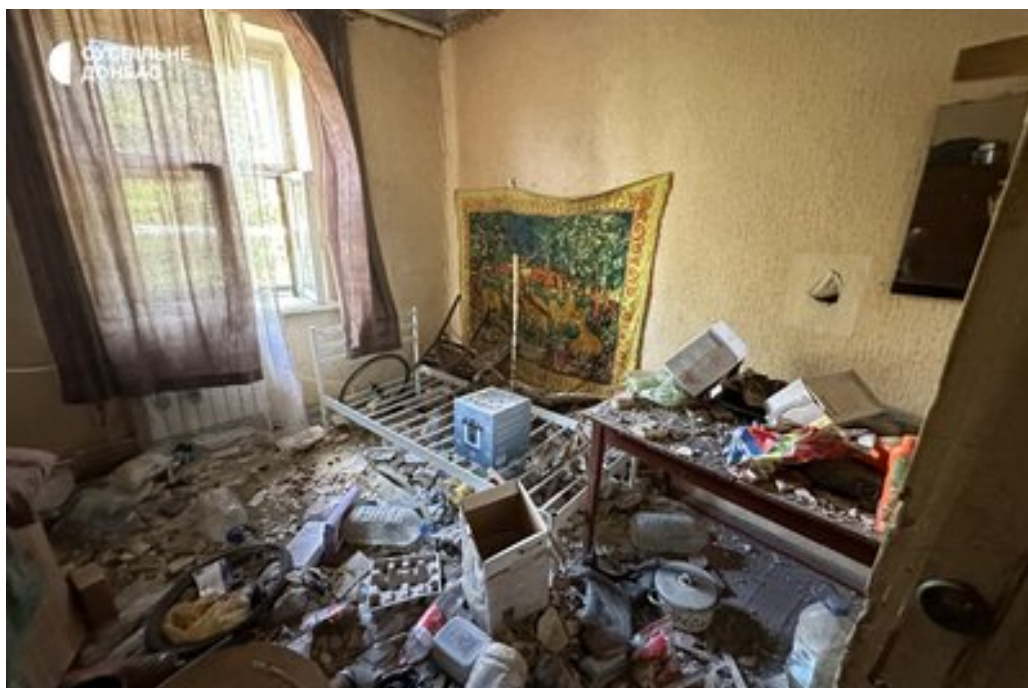
Пошкоджена кімната всередині гуртожитку, Мирноград, Донецька область, 1 серпня 2024 рік. Суспільне Донбас
