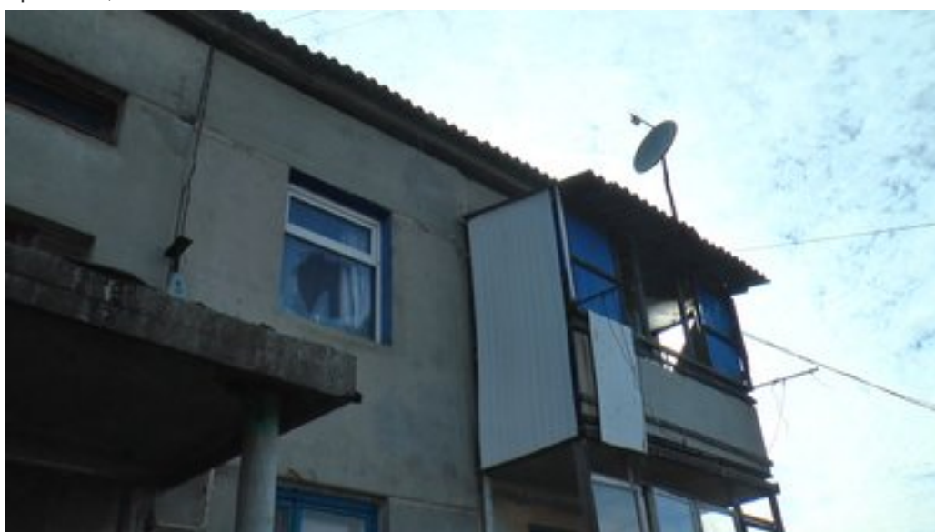
Пошкоджене обстрілами вікно у будинку, прифронтове селище Зоря, Донецька область, лютий 2024 рік. Кадр з відео Суспільне Донбас
