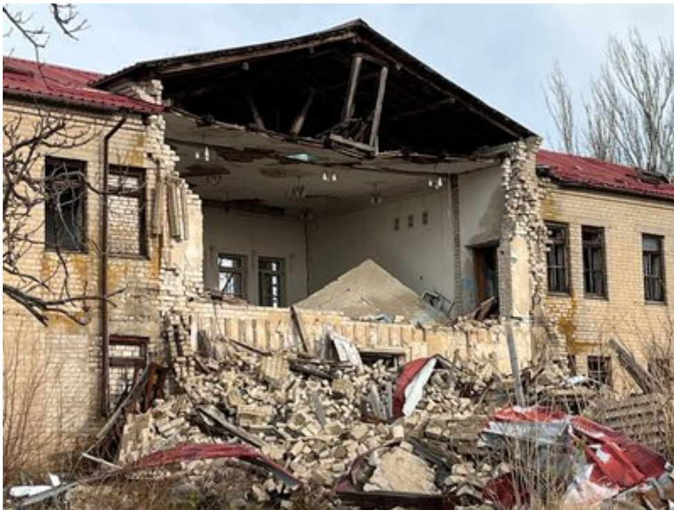
Будинок культури у Березовому після обстрілу РФ. Суспільне Дніпро
